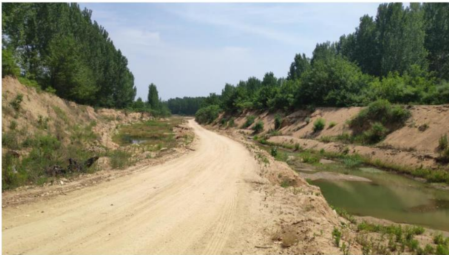
施工道路阻水严重
