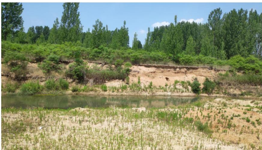
河道岸坡局部直立、垮塌
