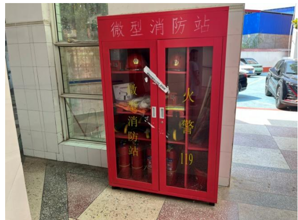
现有微型消防站
